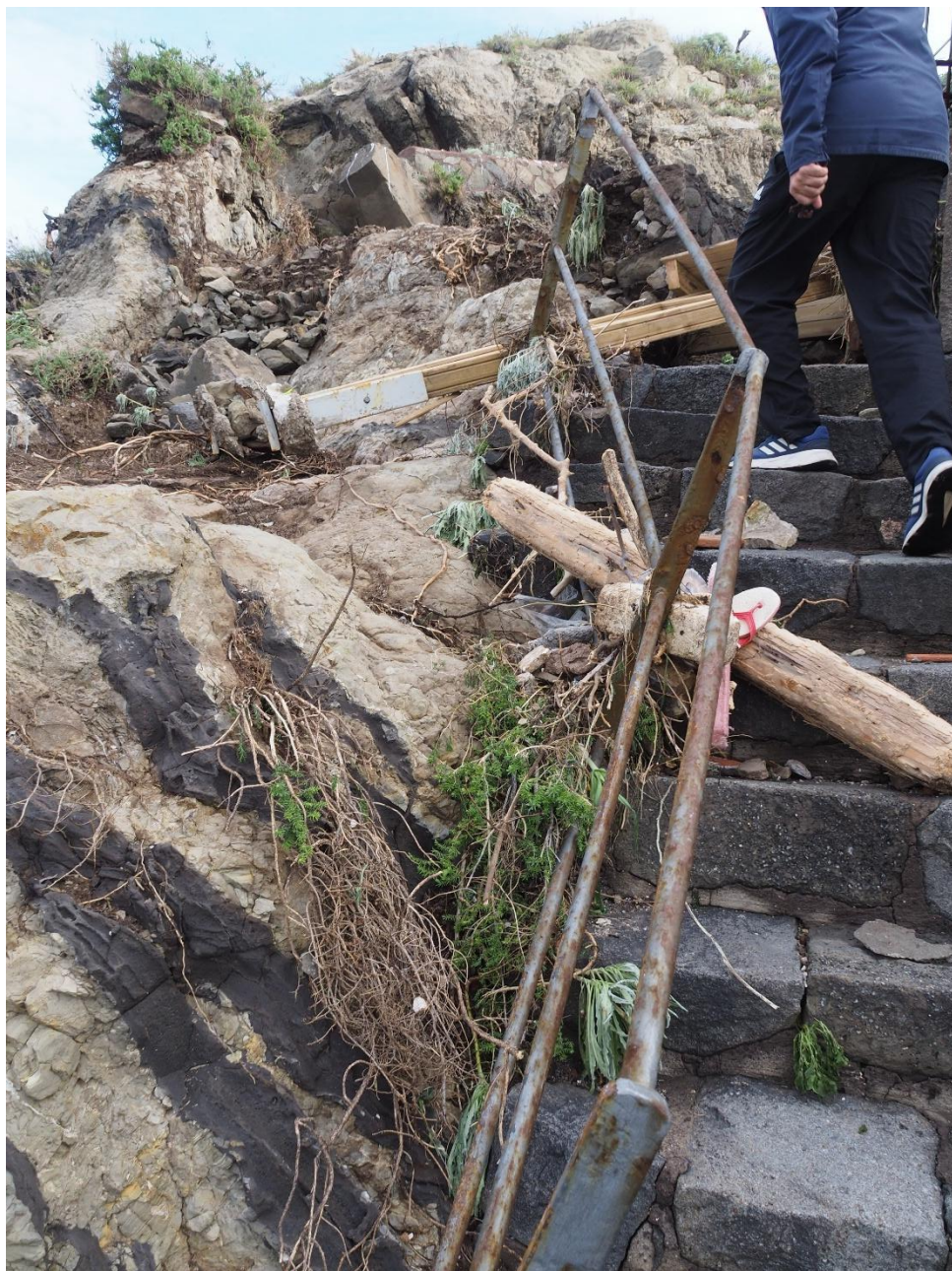
Ringhiera divelta, lato interno
