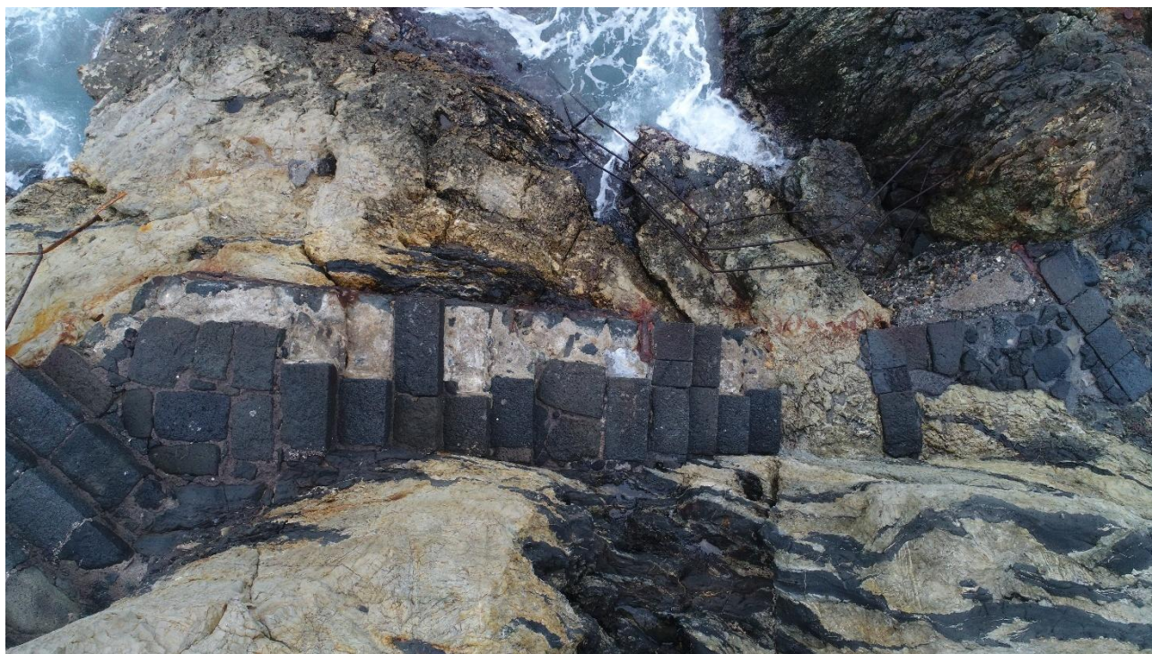
Gradinata danneggiata e ringhiera divelta – Volo drone
