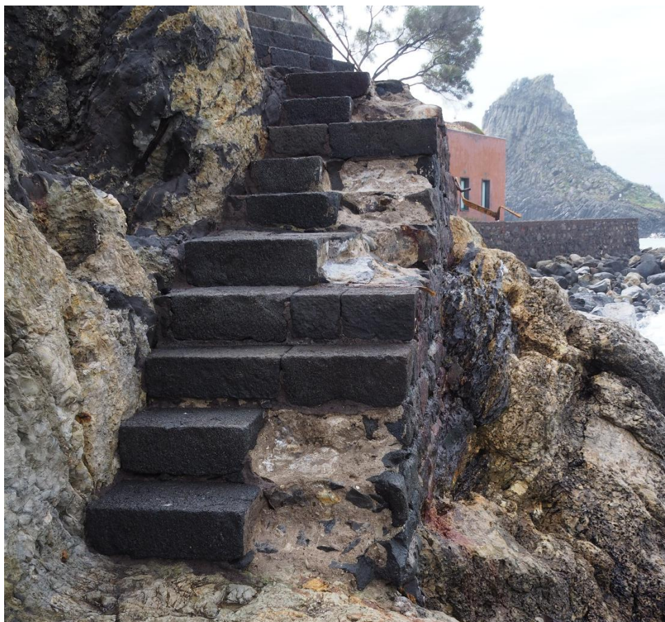
Gradinata danneggiata e ringhiera divelta
