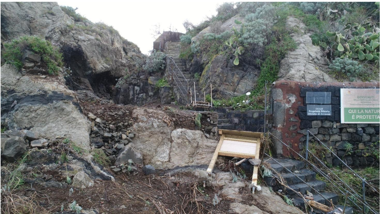
Muro e pilastro distrutti e cancello divolto
